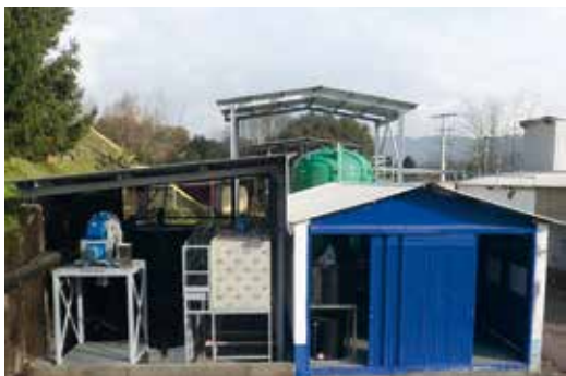
Estación de depuración e tratamento de auga.
