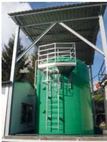
Depósito do sistema de tratamento de auga.
